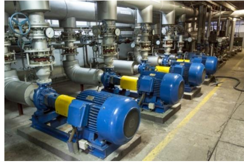
b. Hệ thống trạm bơm nước sạch
